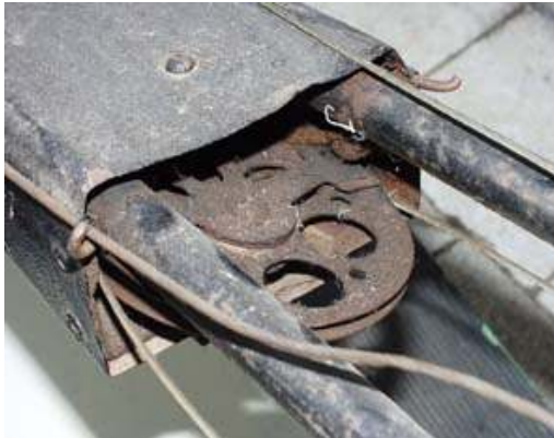
Die Umlenkrolle in ihrem Gehäuse, Vorzustand. Gut zu sehen sind auch die Scharnierstäbe, die den Kasten zusammenhalten.
